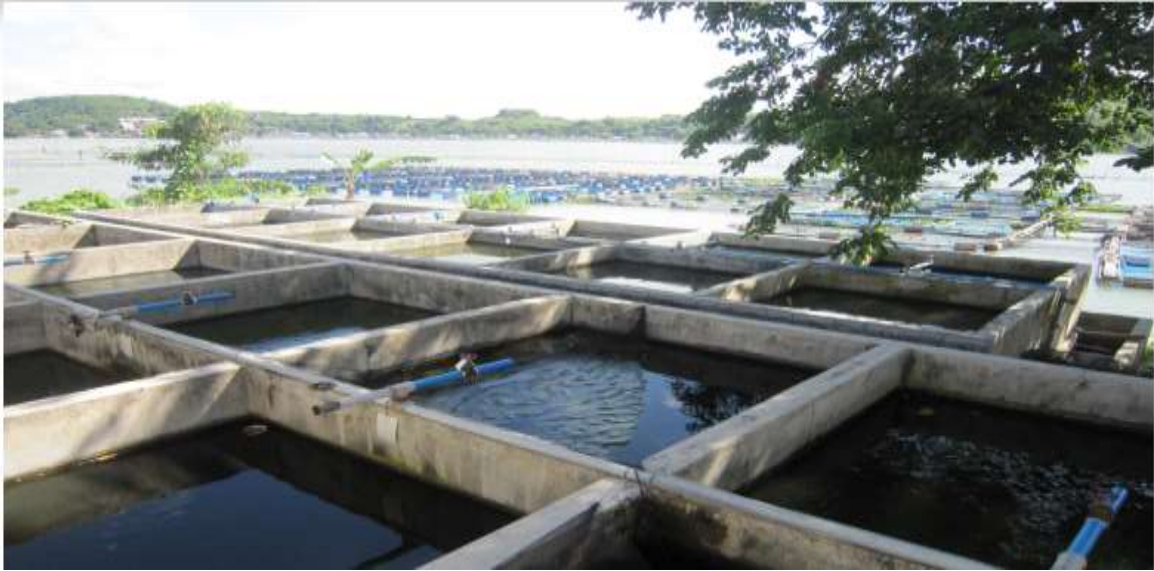
Photo 5 : Bassins en béton armé
