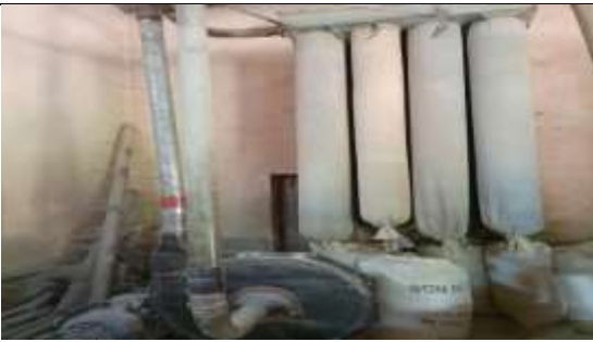
Photo 19 : système de ventilation
