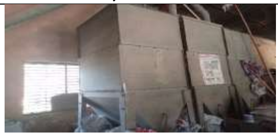
Photo 21 : 3 silos d'une capacité 1 tonne chacun
