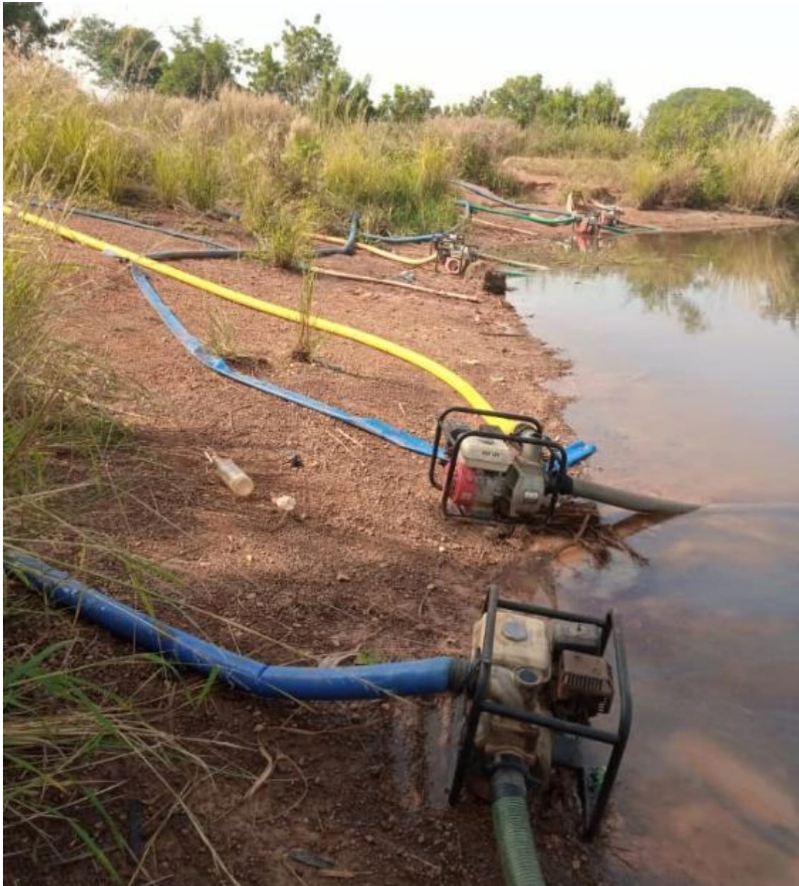
Photo 11 : Motopompes sur les berges du barrage
