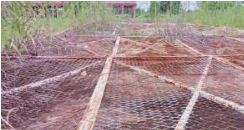
Photo 3: infrastructures en état de dégradation
