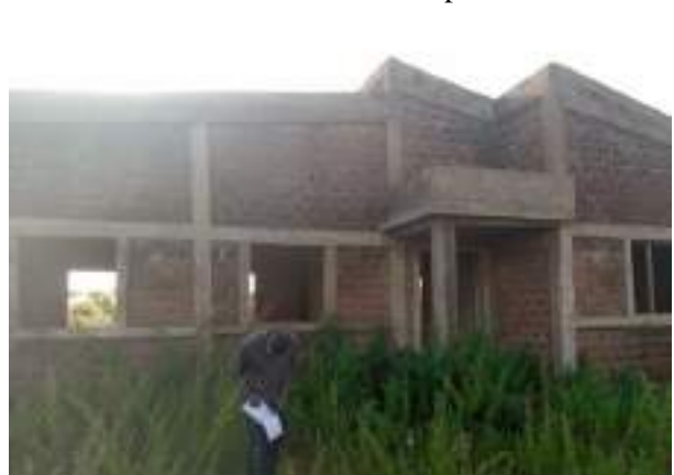
Photo 4: Etat d'un bâtiment non achevé
