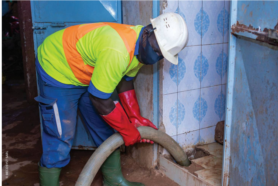
Bobo-Dioulasso : vidange des eaux usées domestiques
