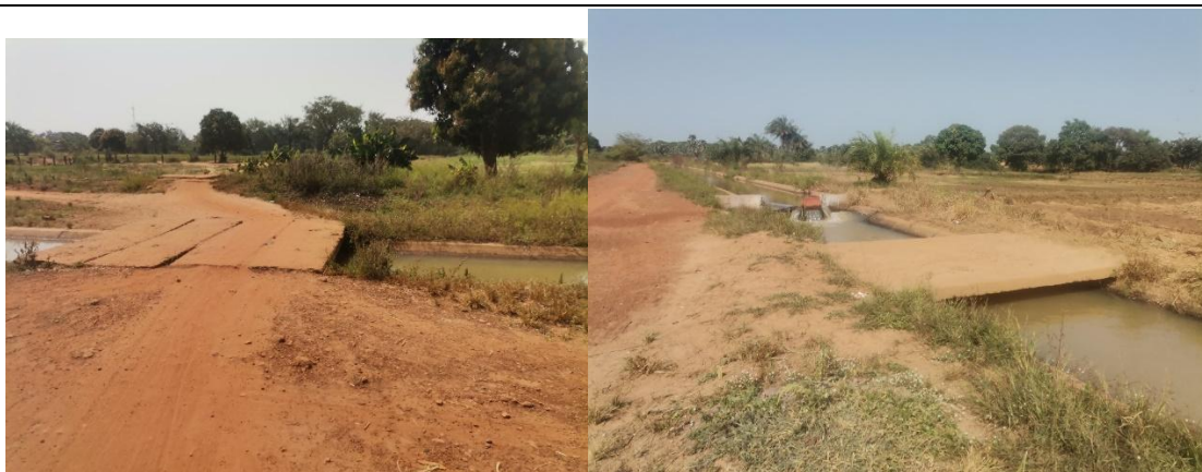
Photo 2. Dalots de traversée du canal primaire
